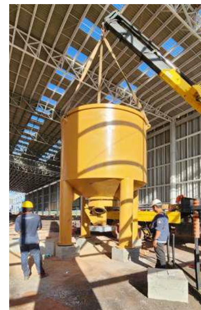
Instalação do pulper de celulose – Caucaia/CE
